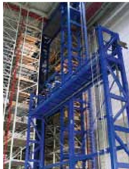
Das Hochregallager arbeitet mit zwei Kommissionierungsanlagen, die in vier Gängen agieren
